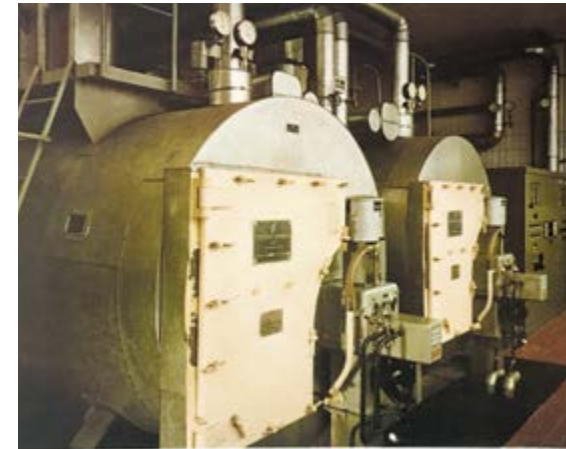
Die Kesselanlage im Heizwerk Sarstedt. Sie wurde 1965 von der kwg in Betrieb genommen und versorgte 342 Miet- und Eigentumswohnungen mit Wärme und Warmwasser. 2007 wurde die Anlage in ein Pellet-Heizwerk umgebaut und versorgt seitdem fast jeden zehnten Haushalt in Sarstedt mit größtenteils klimaneutraler Wärme.
